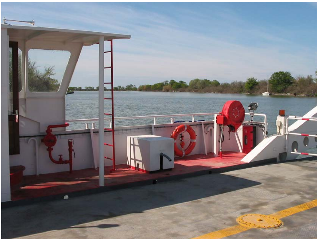
Sauvage 3, poste incendie avant bâbord (motopompe 27 m 3 /h et RIA)
